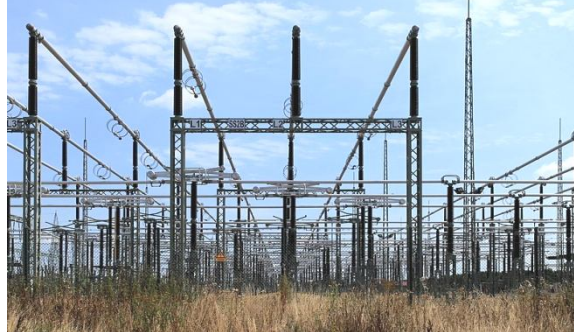
Figure 1.9 : Jeux de barres d'un poste 380KV
