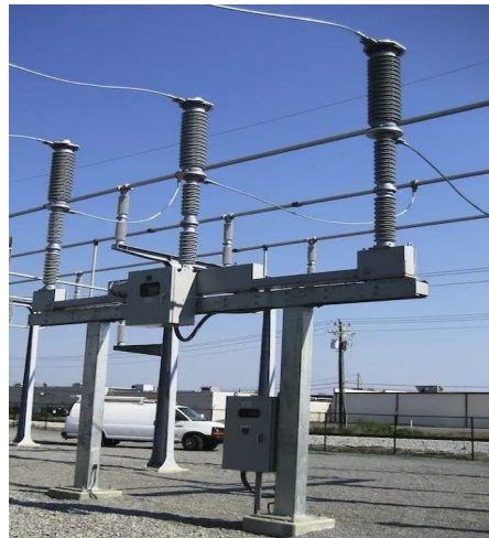
Figure 1.10 : Disjoncteur haute tension
