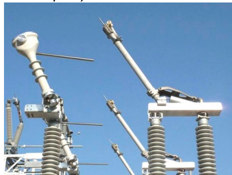
Figure 1.11 : Photo d'un sectionneur haute tension
