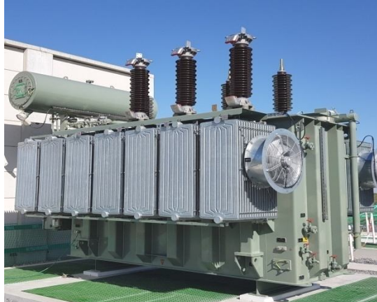
Figure 1.12 : Transformateur de puissance
