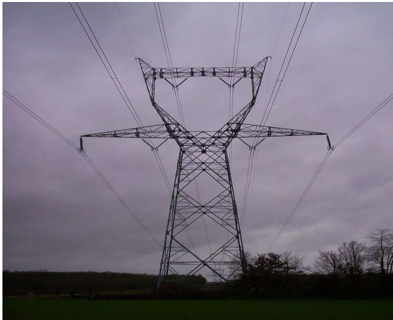
Figure. 31 : pylônes supportant deux lignes 230/400 KV
