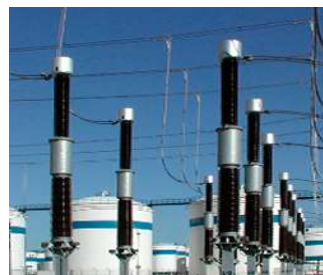
Fig. 1.10 : transformateur de tension
