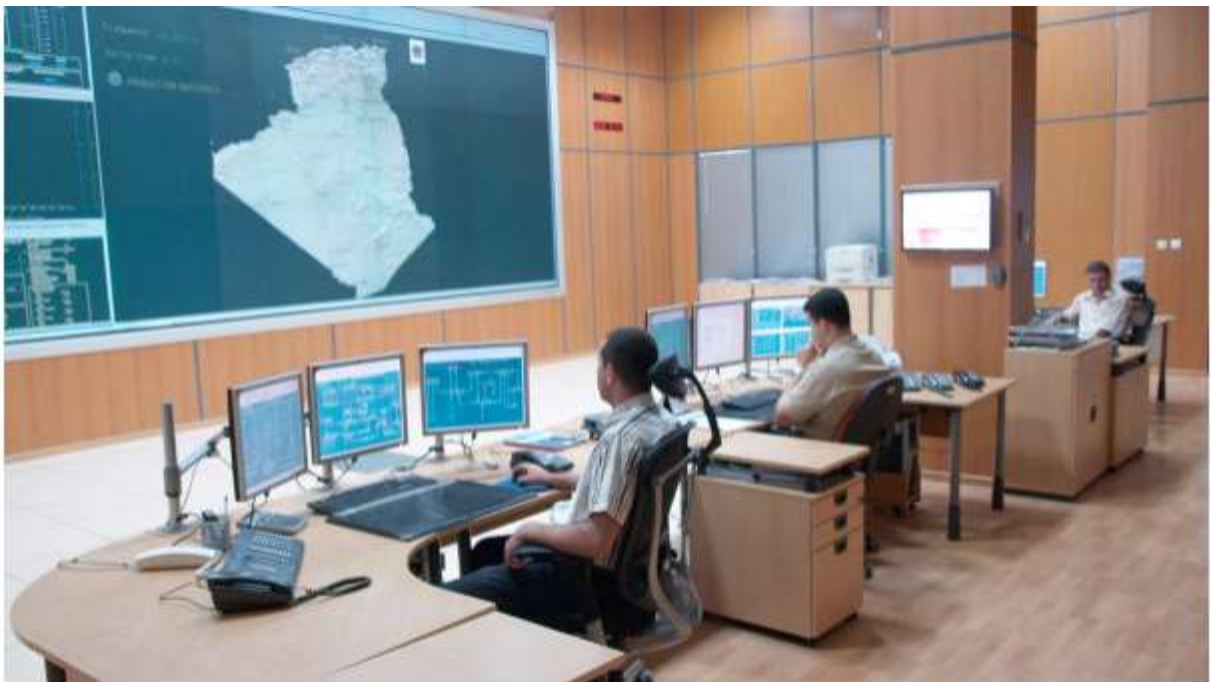
Fig. 1.21: Centre de dispatching Nationale OS/SONELGAZ
