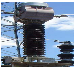
Fig. 1.9 : transformateur de courant
